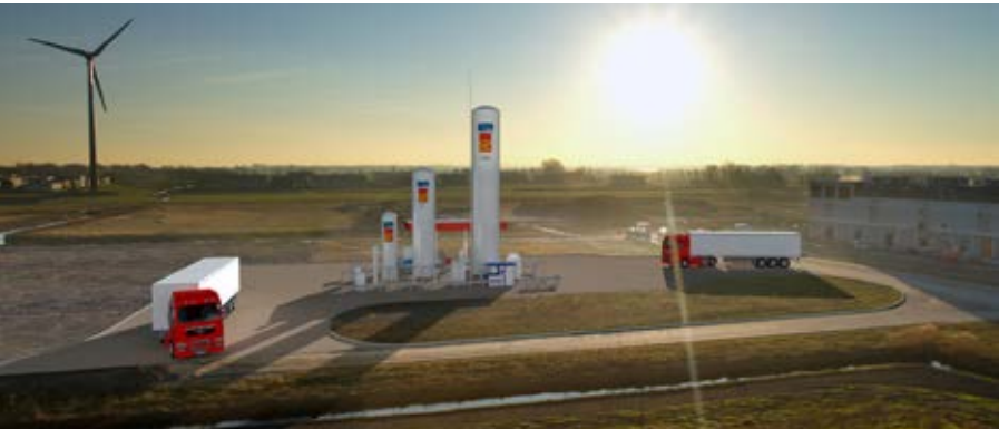
(bio-) LNG station
